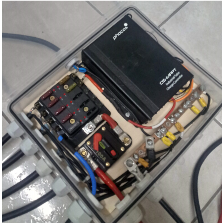
Figura 5.3: Caixa estanque com controlador de carga, disjuntor geral e fusíveis.
