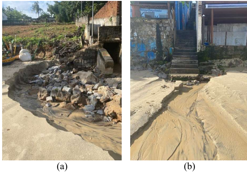
Figura 43: Retirada de sedimentos praias por (a) galeria pluvial (b) fluxo superficial através das escadarias de acesso a pedestres.
