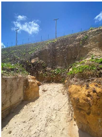
Figura 62: Erosão a jusante de estrutura de contenção.
