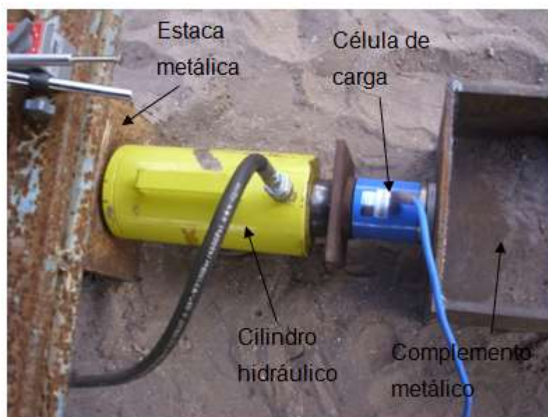
Figura 3.26 – Detalhe de aplicação de carga em uma prova de carga estática em estaca metálica.
