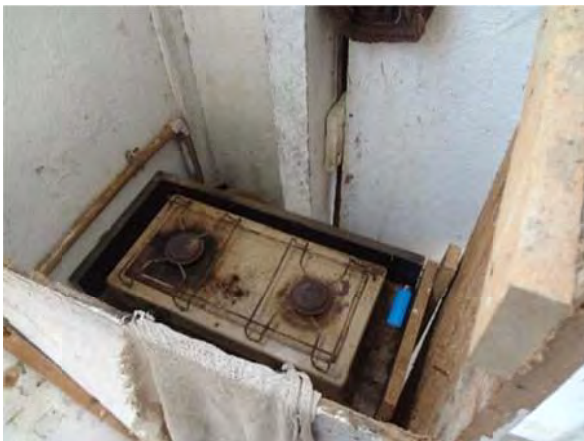
Figura 36 – Fogão a gás existente para esquentar a alimentação dos funcionários
