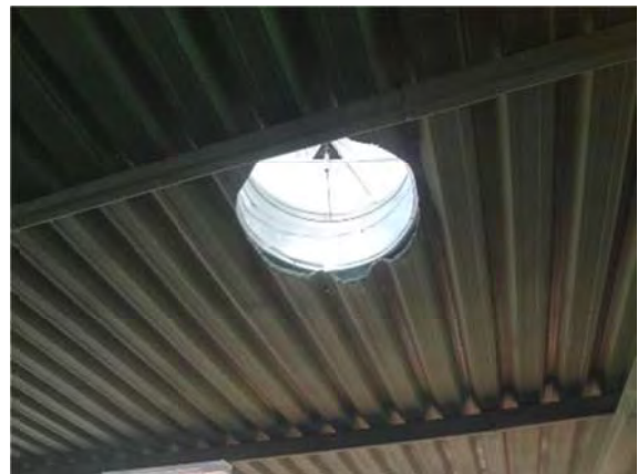
Figura 69 – Exaustores industriais implantados na cobertura do refeitório
