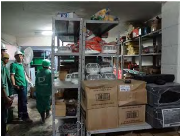
Figura 12 – Almoxarifado improvisado na garagem de um imóvel alugado vizinho à obra
