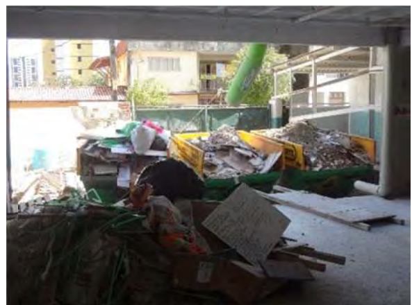
Figura 17 – Caçambas de resíduos. Grande quantidade de resíduos devido à falta de gestão
