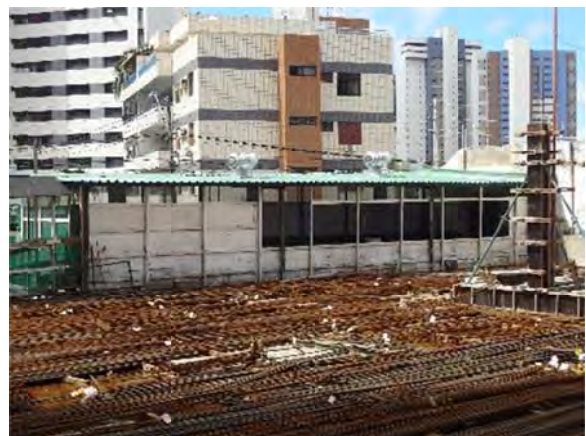
Figura 78 – Ferragens espalhadas no pátio da obra e refeitório com aberturas teladas
