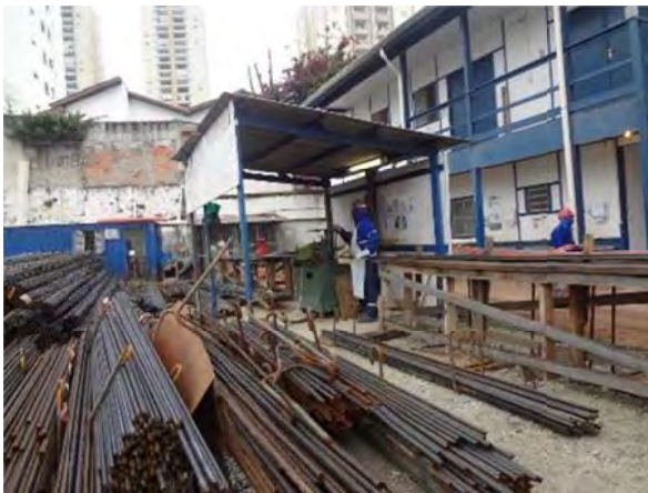
Figura 135 – Central de armação com vergalhões espalhados no pátio do canteiro de obras
