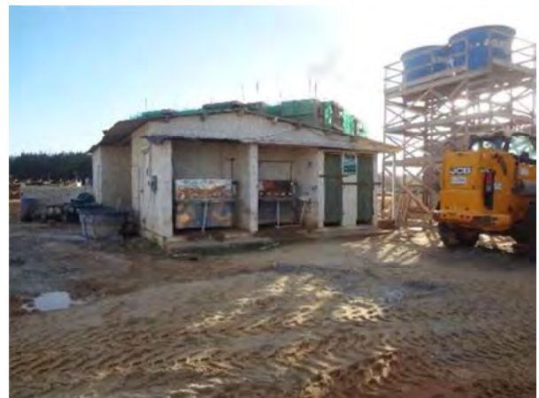
Figura 112 – Bebedouros e banheiros próximos a central de argamassa com abastecimento de água
