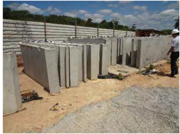
Figura 58 – Local destinado para armazenagem de peças prontas. Lajes e lanços de escadas
