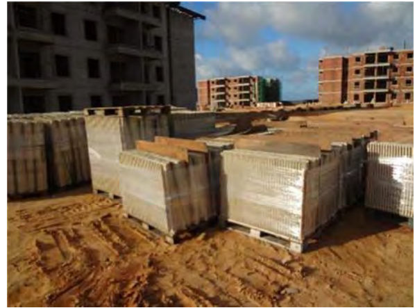
Figura 114 – Gesso acartonado sob pallets próximos ao bloco de apartamentos
