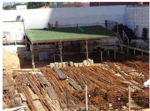
Figura 97 – Central de armação e vergalhões
