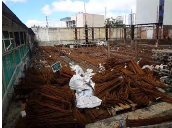
Figura 73 – Ferragens espalhadas pelo pátio da obra, expostas a intempéries.
