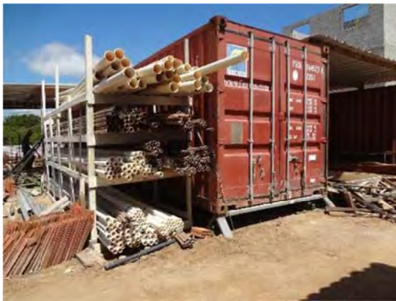
Figura 61 – Container usado como almoxarifado, sem proteção térmica na parte superior
