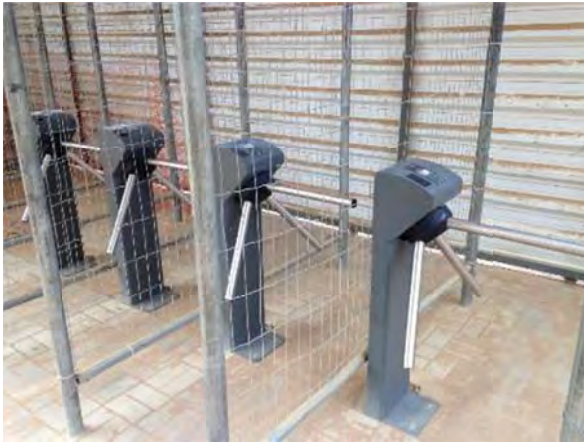
Figura 57 – Catracas eletrônicas instaladas na entrada do canteiro de obras
