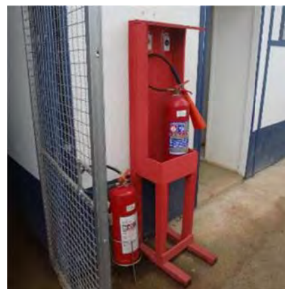
Figura 138 – Equipamentos de combate a incêndio e placas de sinalização em toda a obra
