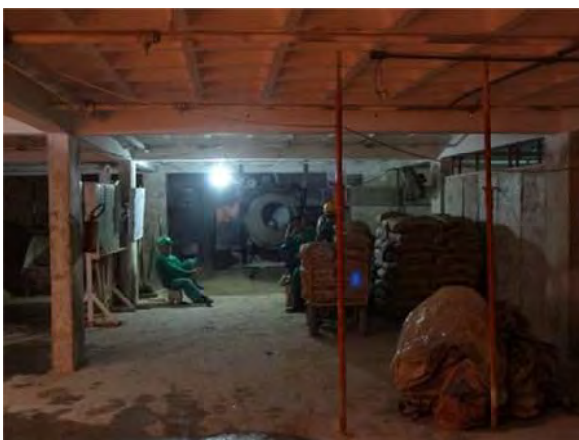
Figura 16 – Central de argamassa localizada no subsolo. Local sem ventilação
