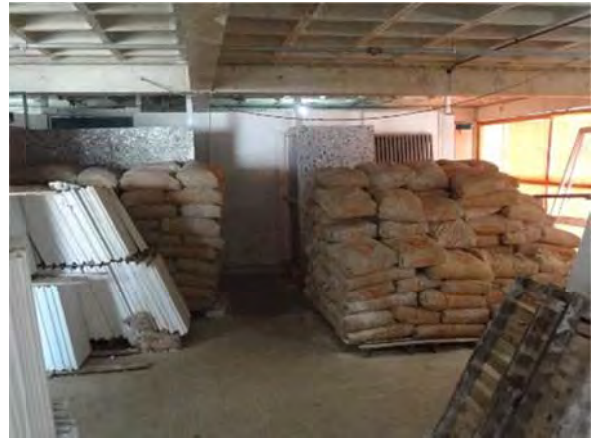
Figura 15 – Almojarifado de cimento e gesso localizado no subsolo de uma torre residencial
