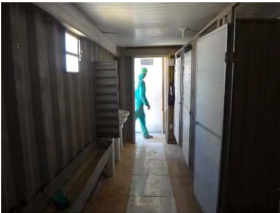
Figura 82 – Banheiros com a área da janela inferior ao mínimo estabelecido pela NR-18
