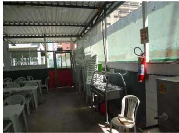
Figura 99 – Acesso ao refeitório com gôndola do buffet e equipamento de combate a incêndio
