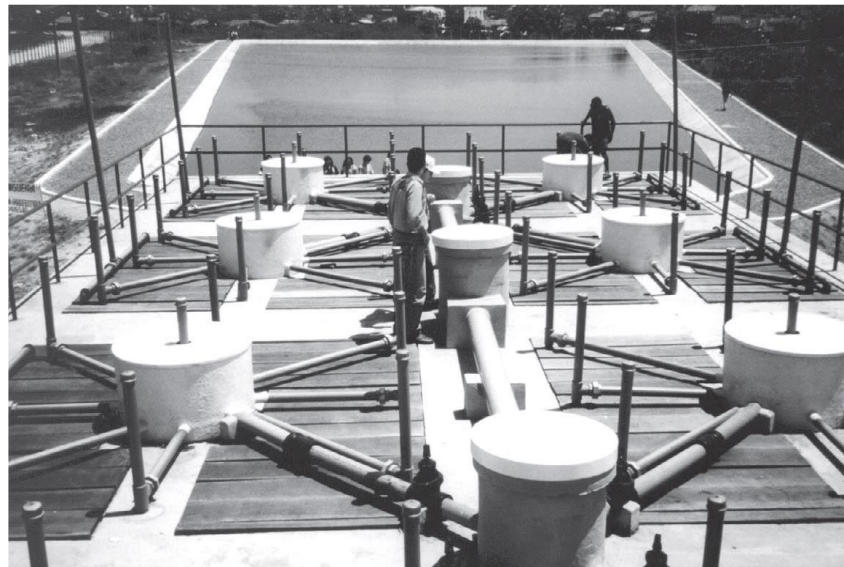
Figura 7- Estrutura de distribuição do efluente da ETE Mangueira em Recife-PE.
