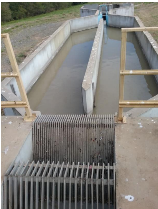
Figura 5 – Desarenadores (ao centro) da ETE Rio Sorocaba.
