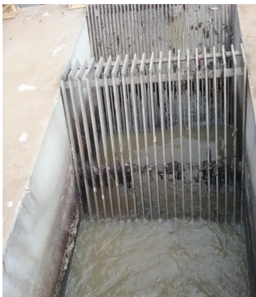
Figura 4 – Gradeamento manual da ETE Rio Sorocaba.
