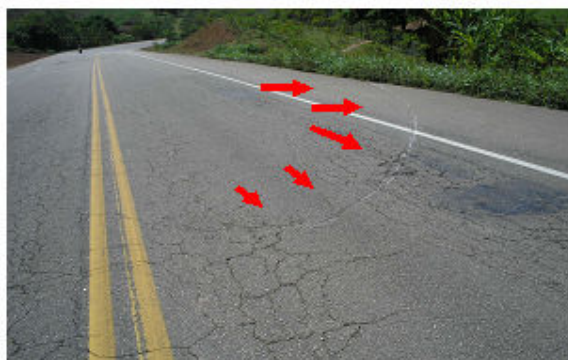
Figura 56 - Local do acidente com marca, rasgo na pista.
