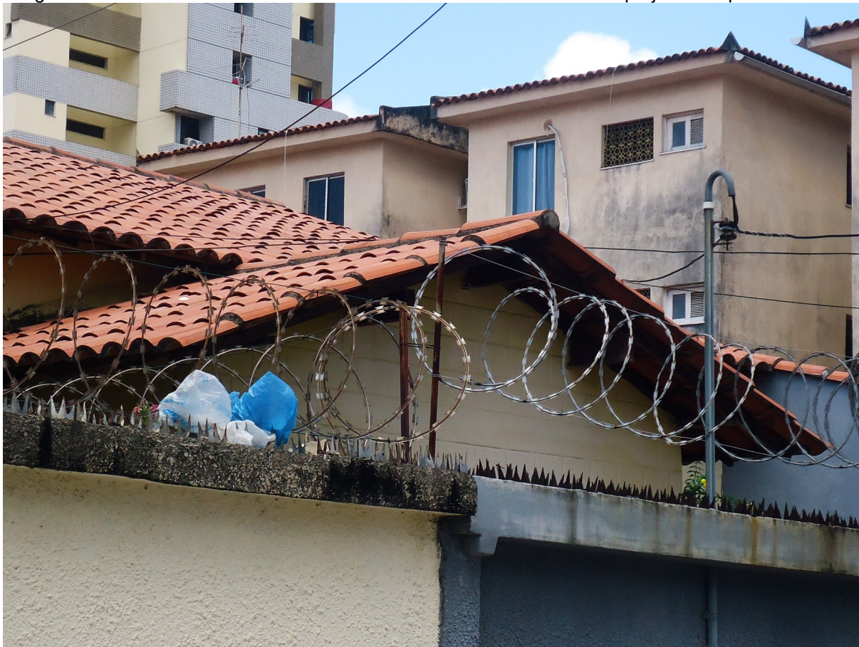
Figura 127 — Casa remanescente da Vila Ferroviária da Aldeota: visão prejudicada pelo muro alto
