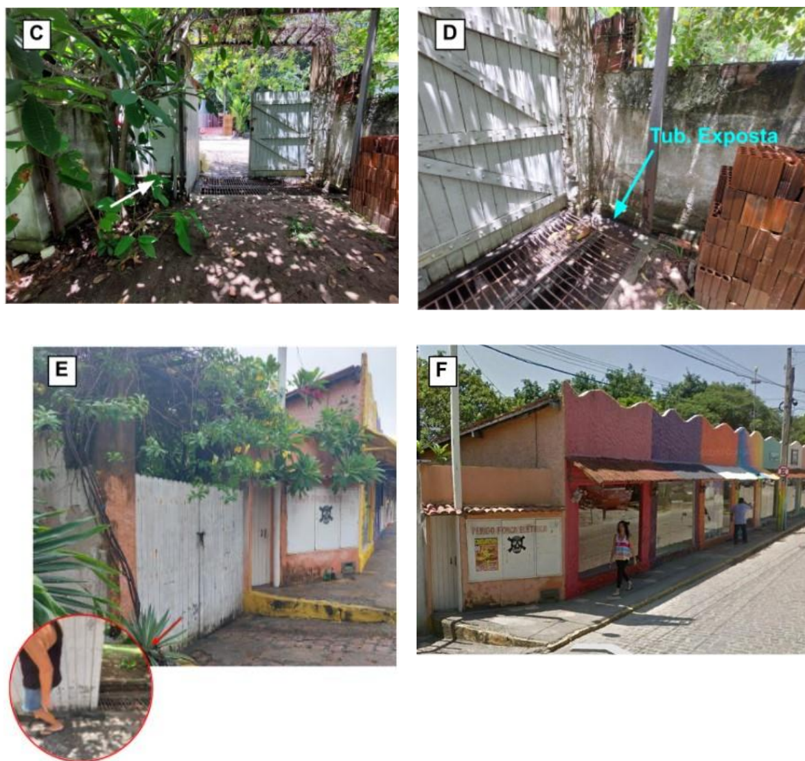
Figura 51: Drenagem pluvial do centro comercial é escoada para tubulação exposta na praia. Em (A), (B) e (C) é possível observar o caminho da drenagem até chegar na embocadura para a tubulação 1 (D); (E) desgaste na pintura do portão e desnível da residência em c comparação com a avenida; (F) estabelecimentos comerciais que fazem parte da propriedade privada. Fonte: Autora (2022); Google (2020) na imagem F.
