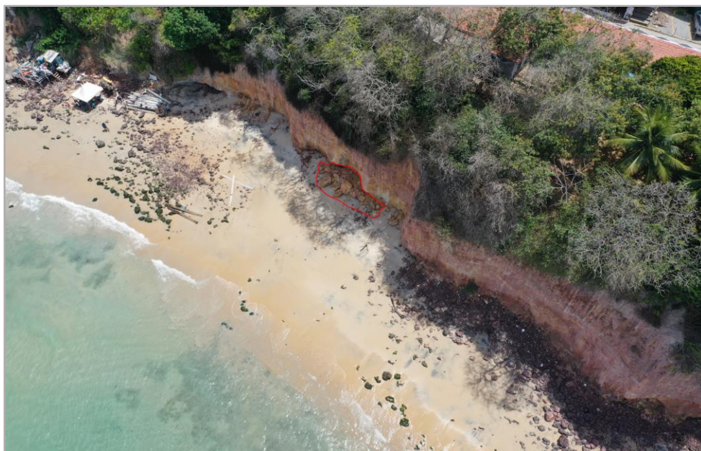
Figura 33: Blocos desagregados, destacados em vermelho, oriundos de queda do material sedimentar por meio da associação do grande volume de chuva e alto nível da maré, resultando no acidente fatal em novembro de 2020. Fonte: Jesimael Avelino (2020).
