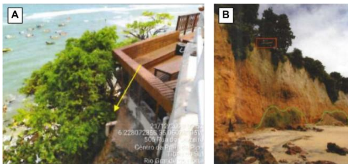
Figura 53: Irregularidades vistoriadas pelo IDEMA destacadas em amarelo e vermelho, respectivamente: (A) tubulação observada no U Bistrô; (B) Tubulação exposta na face da falésia.
