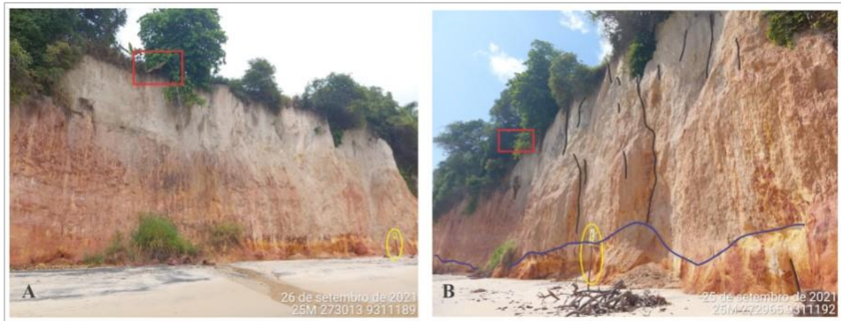
Figura 28: Tubulação exposta na falésia drenando água da chuva proveniente da avenida, destacada em vermelho (A); foram observadas fraturas de deslocamento (traços pretos) e erosão basal (em azul) bastante proeminentes, próximos à tubulação, como referencial a proeminentes, próximos à tubulação, como referencial a placa de alerta no círculo amarelo (B).
