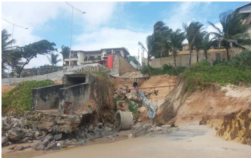
Figura 2. Erosão, degradação da orla marítima e rede de água pluvial com ligação clandestina de esgoto na orla da praia de Ponta Negra/RN
