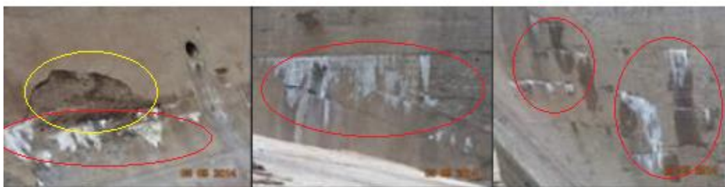
Figura 55: Fuga de água no paramento de jusante.
