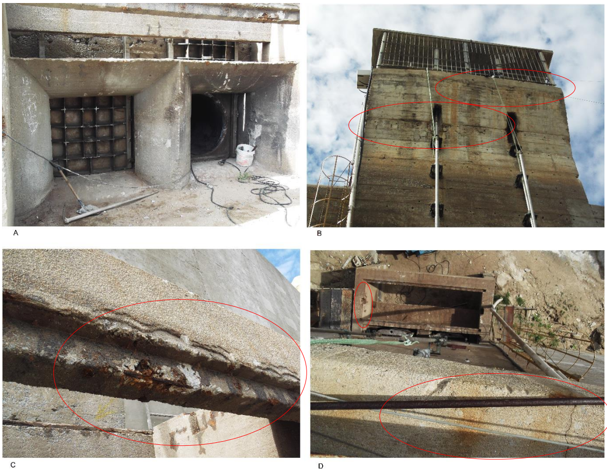
Figura 61: Anomalias nos equipamentos hidromecânicos.
