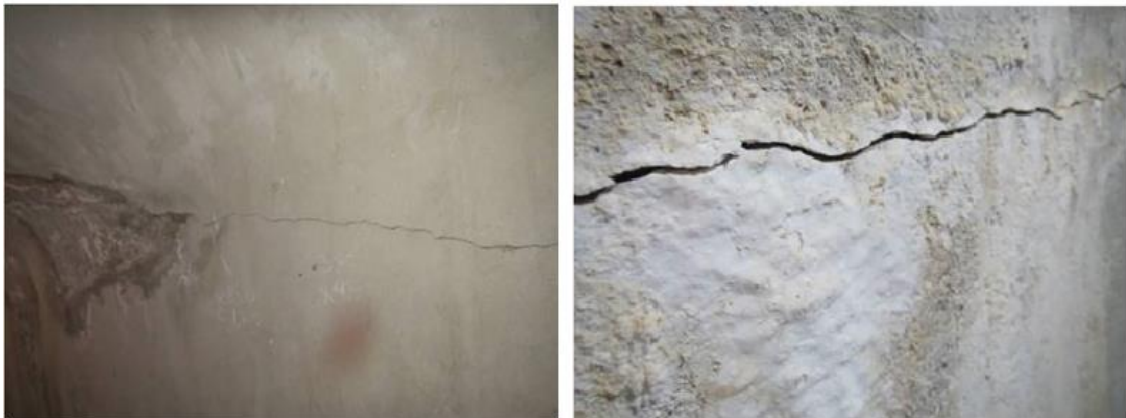
Figura 48: Rachadura na entre o teto da galeria e a parede do paramento de jusante.
