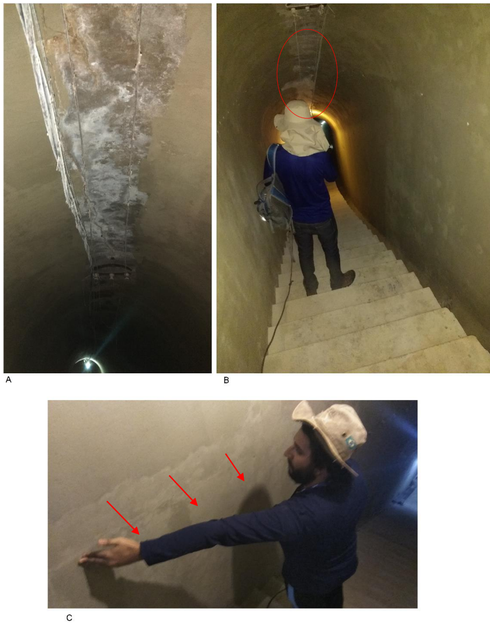
Figura 65: Carbonatação no teto da galeria.
