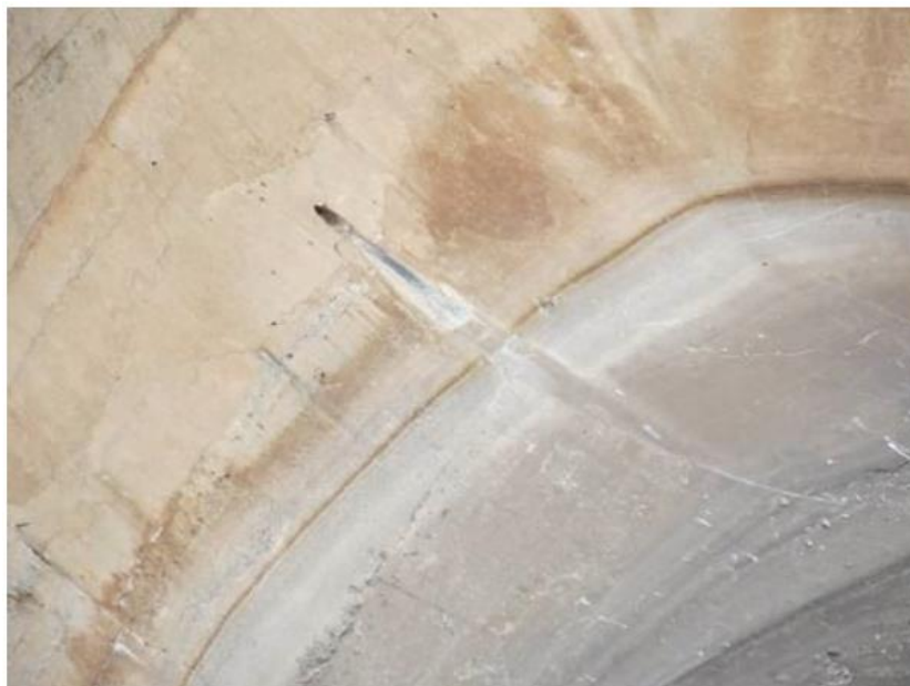
Figura 54: Fissura no vertedouro.
