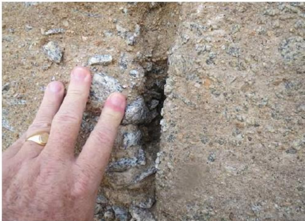
Figura 56: Desagregação do concreto.
