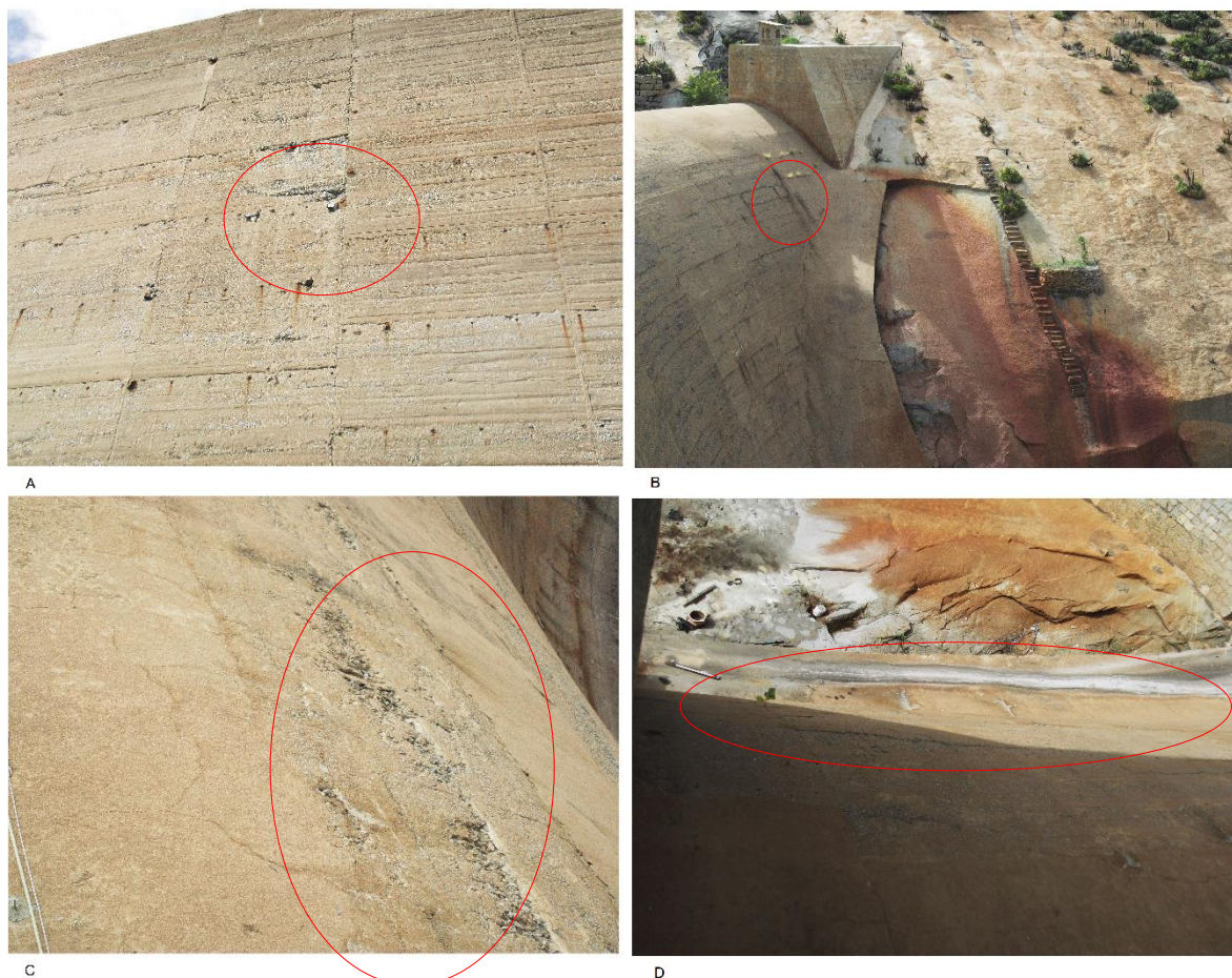
Figura 62: Anomalias nos paramentos.
