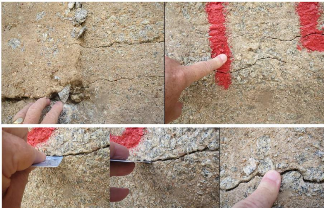
Figura 53: Fissuras horizontais nos paramentos
