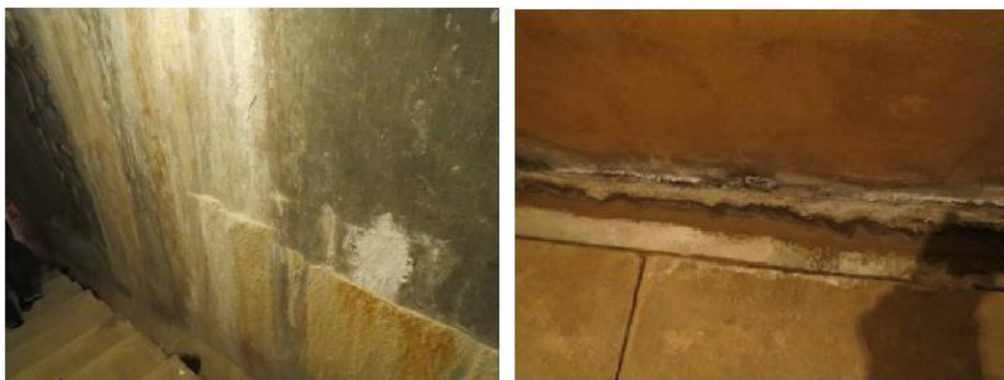
Figura 52: Patologias estruturais nos drenos da galeria.
