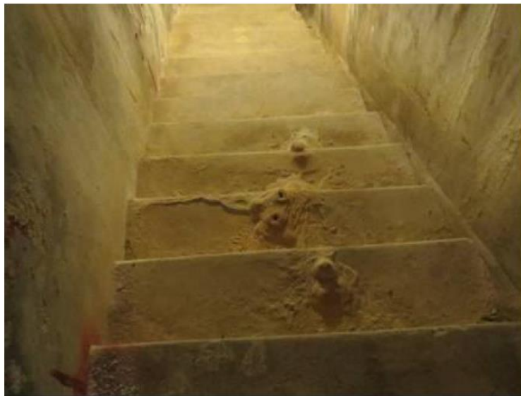
Figura 51: Formação de estalagmites na escadaria da galeria.
