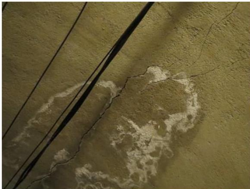
Figura 49: Processo de lixiviação no teto da galeria.
