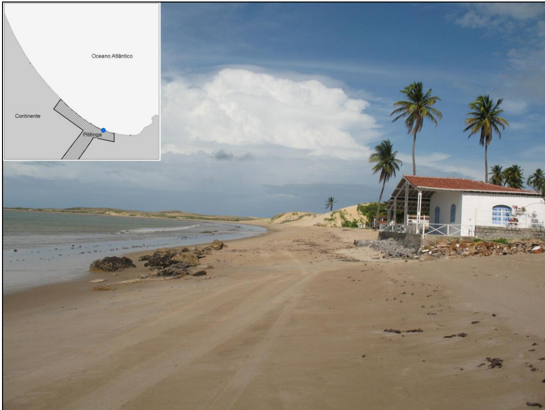
Figura 5.13 – Casa afetada pela erosão costeira fazendo uso de instrumentos para conter a erosão. Foto: Eduardo Q. de Lima.
