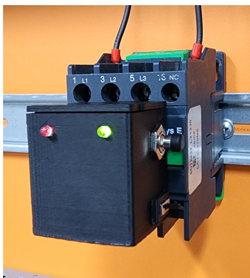
Figura 33 – Dispositivo SmartContact instalado.
