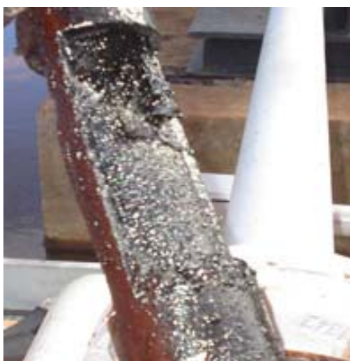
Figura 5.20. Elemento sujo do filtro de descarga da bomba do aquoso.
