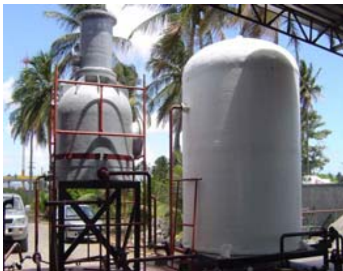
Figura 4.10: UT-MDIF em montagem sobre skid metálico.
