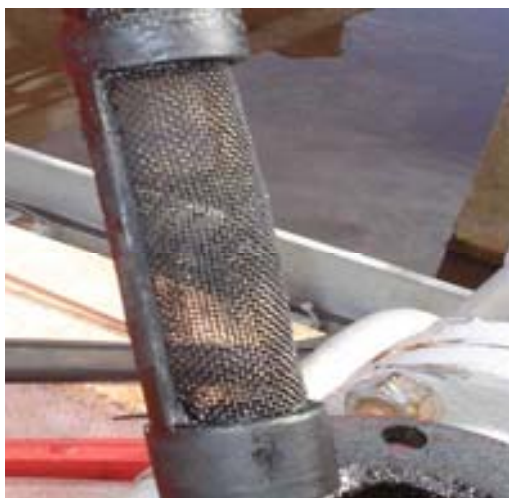
Figura 5.19. Elemento limpo do filtro de descarga da bomba do aquoso.
