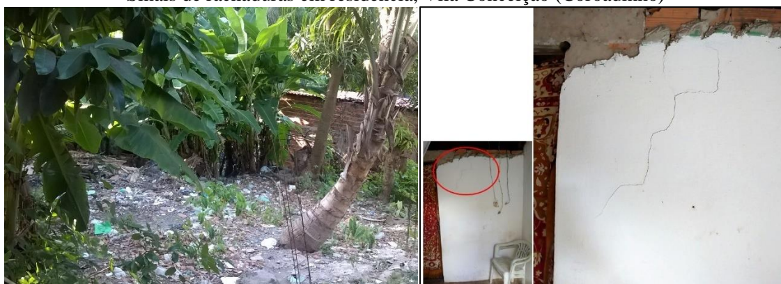
Figura 13: Plantação de banana em área de encosta, Vila Bacanga (Itaqui Bacanga). Figura 14: Sinais de rachaduras em residência, Vila Conceição (Coroadinho)
