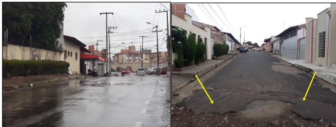
Figura 67 – Área com asfalto sem sinais de deterioração (à esquerda) e Figura 68 - Asfalto com fraturas de erosão (à direita)
