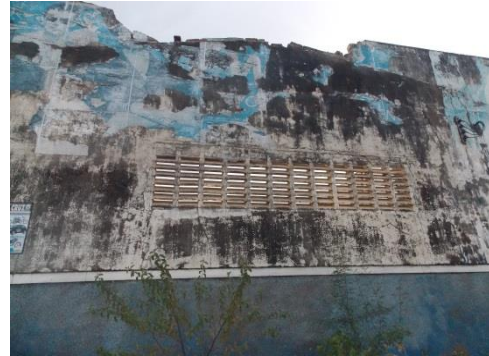
Figura 73: Trecho da fachada que ruiu.
