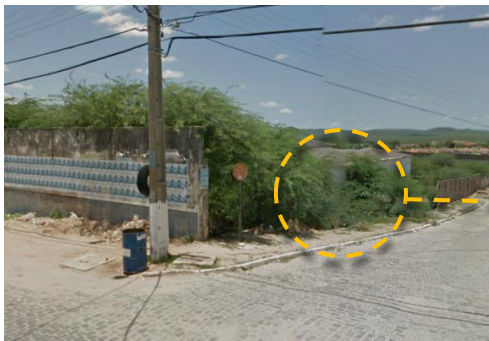
Figura 74: Vista lateral sem o muro que caiu - Rua Walker Macedo.
