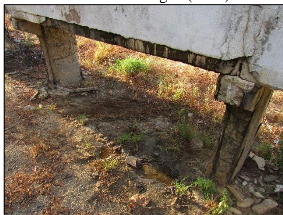
Figura 30. Perímetro irrigado de Itans – Caicó/RN: trecho deteriorado na estrutura do canal principal com vazamento de água (2018).
