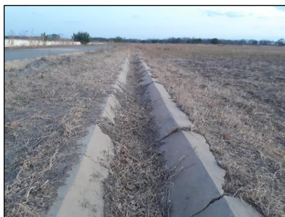
Figura 34. Perímetro irrigado de Sabugi-Caicó/RN: estrutura do canal secundário ocupada por areia e entulhos (2018).
