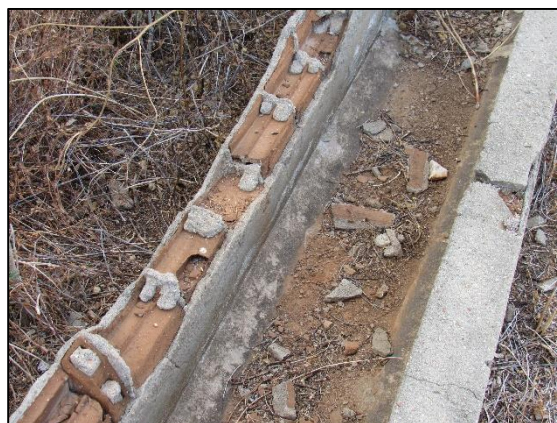
Figura 32. Perímetro irrigado de Itans - Caicó/RN: estrutura do canal secundário ocupado por areia e entulhos (2018).
