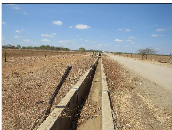
Figura 33. Perímetro irrigado de Sabugi-Caicó/RN: estrutura do canal principal sem presença de água (2018).
