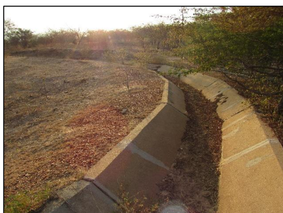
Figura 27. Perímetro irrigado de Cruzeta: canal principal tomado por sedimentos e entulhos (2018).
