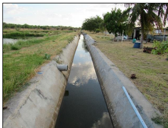
Figura 19. Caicó/RN: Canal principal da Estação de piscicultura Estevão de Oliveira (2018).
