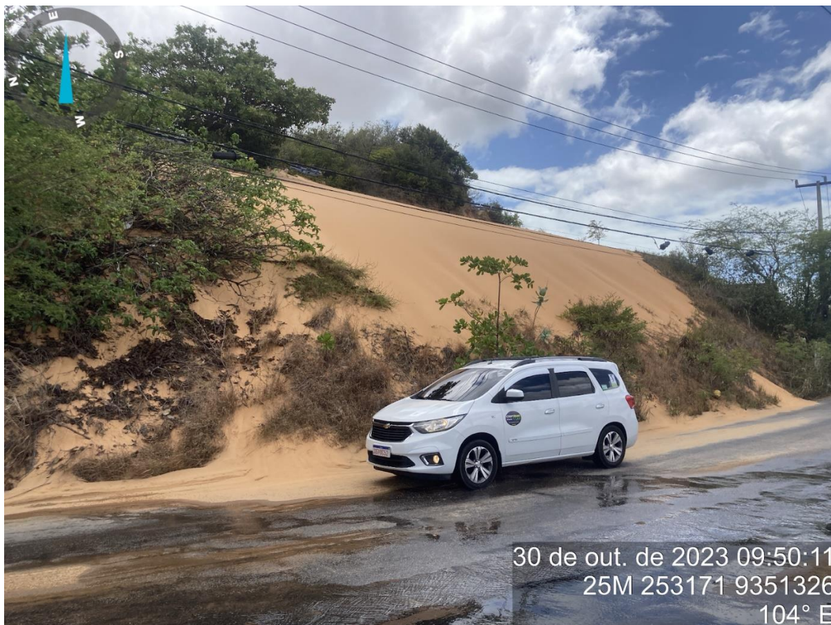
Figura 5.21 - Superfície dunar adentrando a Avenida dos Xavantes, na subzona 1-B, bairro de Pitimbú, veículo perfaz o percurso no momento da imagem.
