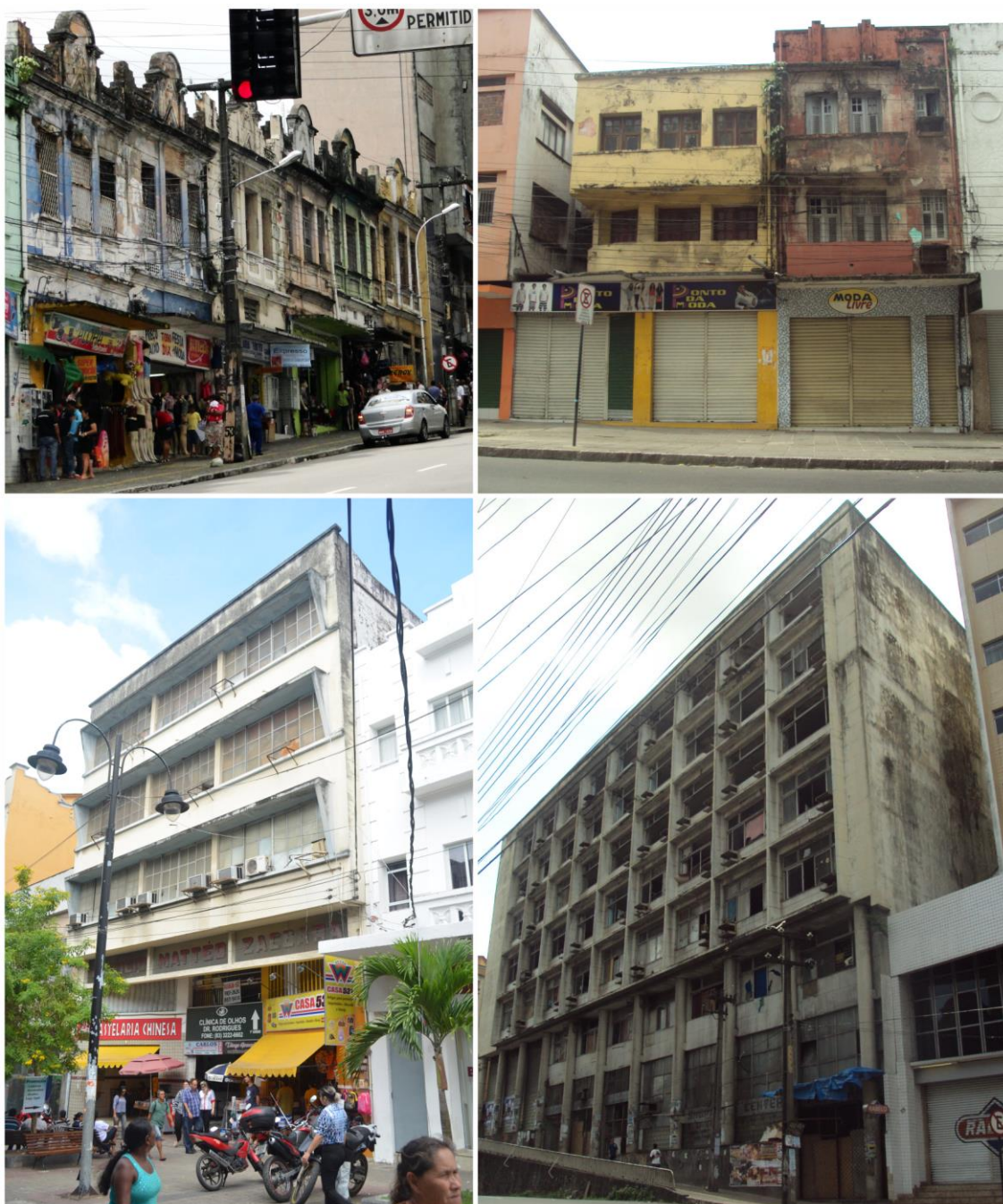
Figura 98 – Imóveis com pavimentos superiores sem uso nos eixos mais integrados da Cidade Alta. Fonte: Acervo Pessoal.
