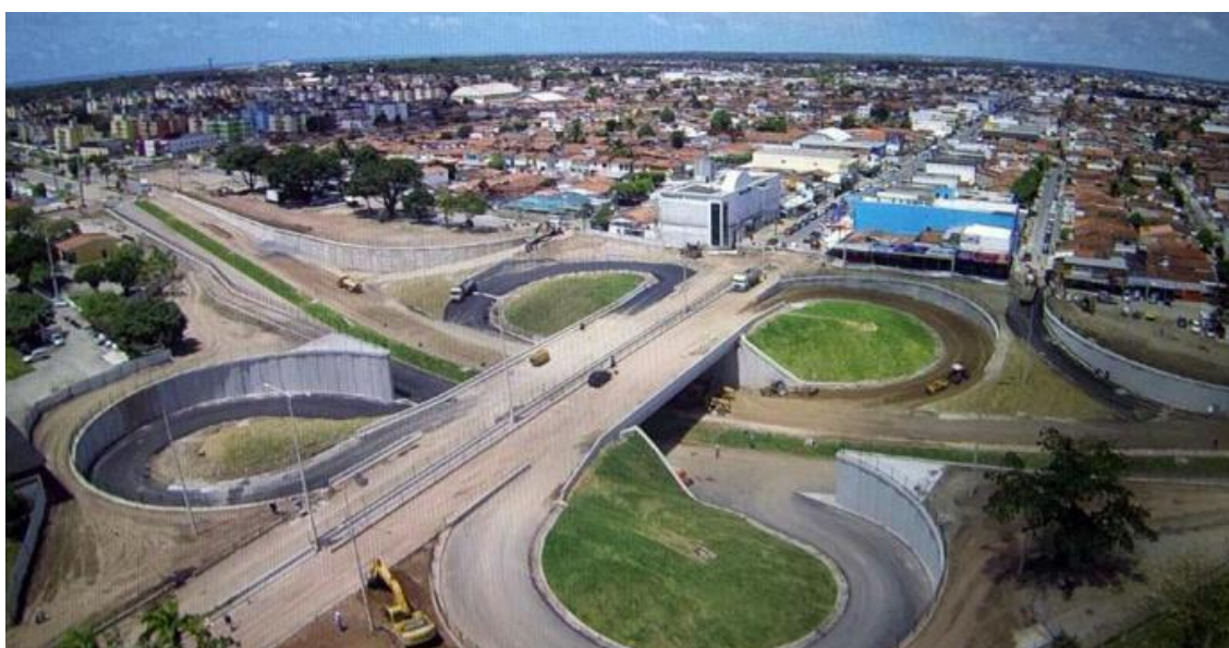
Figura 42 – Vista aérea do Trevo das Mangabeiras. A Av. Hilton Souto Maior – que dá acesso a BR-230 e ao Mangabeira Shopping – cruza o trevo por baixo, enquanto a ligação entre as principais dos Bancários e de Mangabeira acontece por cima. Fonte: Portal Paraíba Já.
