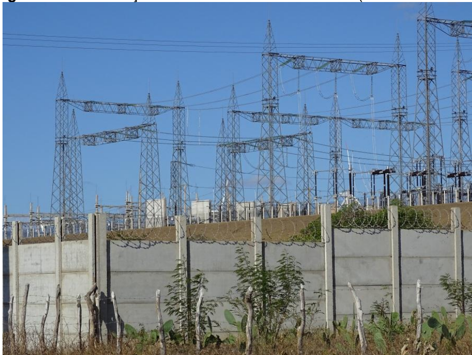
Figura 18 – Subestação João Câmara III – 138/500Kv (João Câmara/RN).
