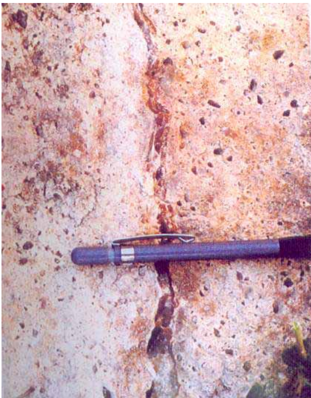
Foto 6.19 – Fratura N-S, aberta e preenchida por sílica, afetando os arenitos da Formação Serra do Martins na Serra de Portalegre. Ponto Pa 41.
