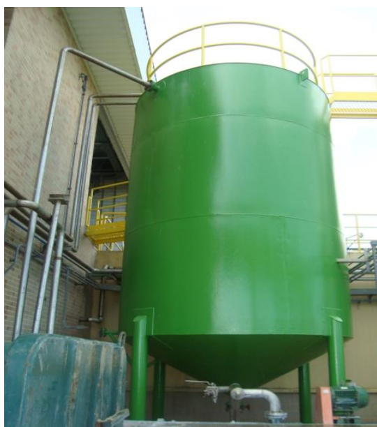
Figura 2.5. - Armazenagem de borra da ETE.
