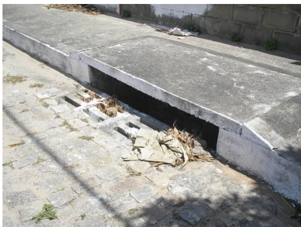
Figura 3.2 Boca de Lobo na Entrada Lagoa Mirassol
