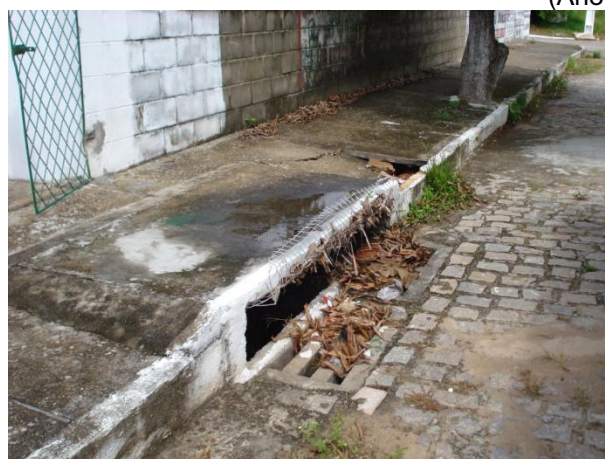
Figura 3.6 Boca de lobo da entrada da lagoa de retenção (Ano 2008).
