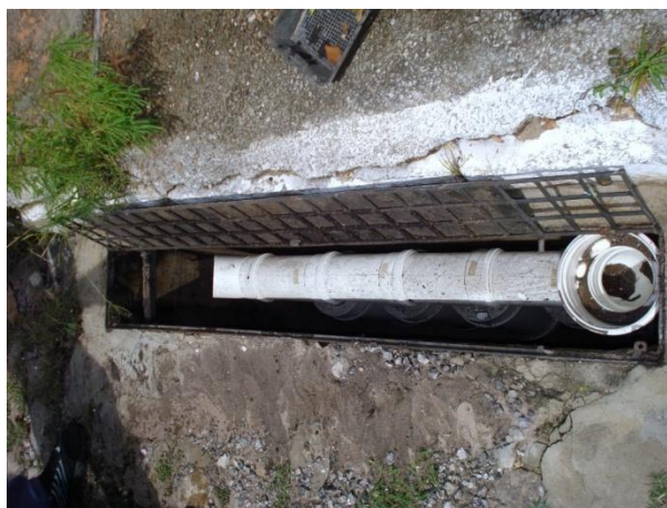
Figura 4.11 Local de instalação do amostrador automático
