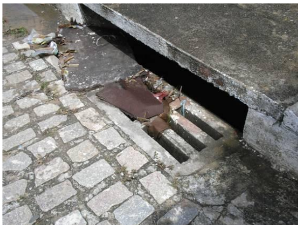
Figura 3.4 Boca de Lobo obstruída com resíduos carreados da superfície (Ano 2007).
