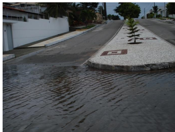
Figura 3.8 – Ponto de alagamento na Bacia C em áreas de cotas baixas da bacia.
