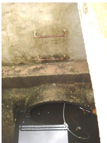
Figura 4.7 Instalação da sucção do amostrador na tubulação de descarga
