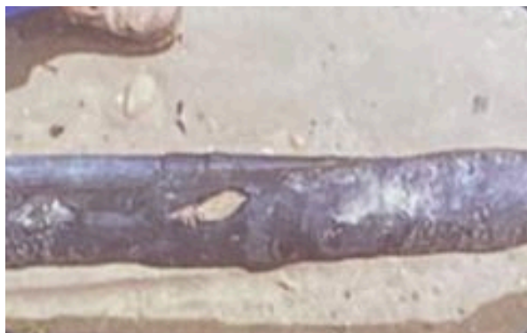
Figura 3: Cabos isolados com falha aparente.
