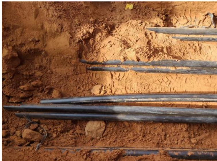
Figura 1: Cabos isolados no solo
