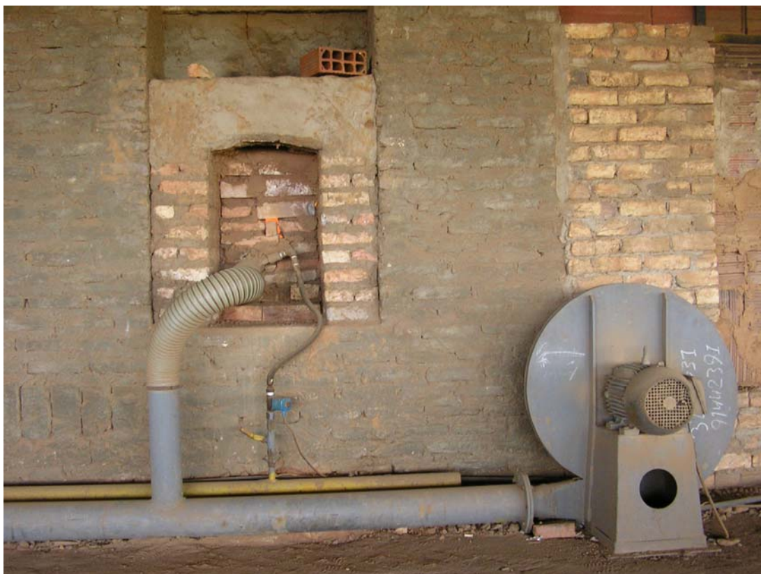
Figura 6.1 – Imagem do queimador e do ventilador do ar de combustão.
