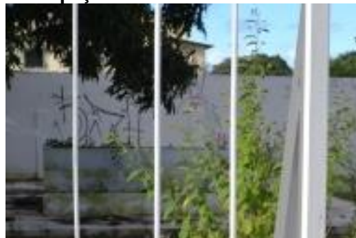
Figura 70 – Problemas de pichação no espaço interno destinado à horta
