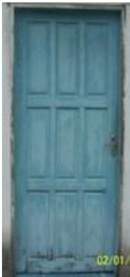
Figura 41: Porta antiga posicionada fora da posição das esquadrias originais da casa.
