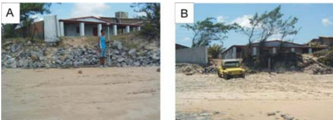
Figura 4.10 - A: Utilização de enrocamento de pedras para minimizar efeitos da erosão costeira. B: Erosão intensa sobre o berma praial, em área com ruptura do arenito de praia e sob forte pressão pelo uso e ocupação antrópica.
