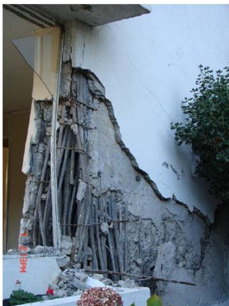
Figura 1.1 – Exemplo de dano causado por elemento sem confinamento
