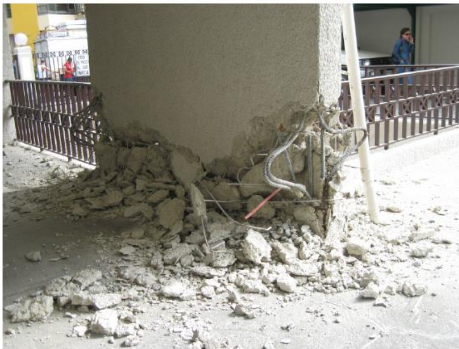
Figura 1.2: Flambagem da armadura longitudinal por falta de estribos
