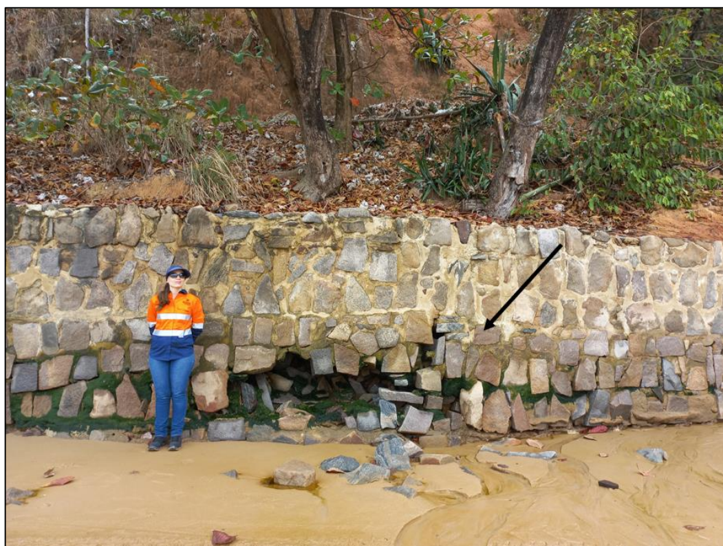
Figura 6.20 - Registro fotográfico da estrutura de contenção (muro de arrimo) danificado na Praia do Porto, localizada no município de Baía Formosa. A foto foi capturada em 25 de outubro de 2022, destacando que a última revitalização ocorreu em junho de 2022.
