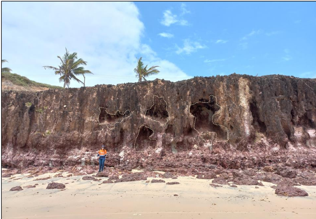
Figura 6.12 – Aspecto das falésias da formação Barreiras localizadas na Praia de Sibaúma, Tibau do Sul. Em destaque diversas cavidades erosivas presente no material rochoso.
