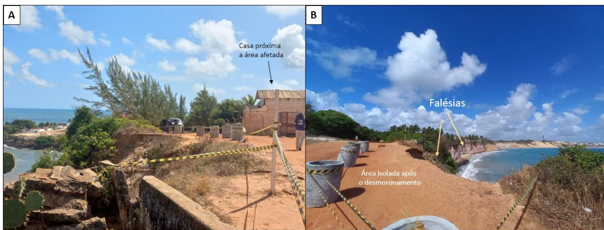
Figura 6.9 – Trecho de uma via que desmoronou a poucos dias antes do campo. Observa-se que o trecho não é pavimentado e é uns dos principais acesso a praia e a parte urbanizada.
