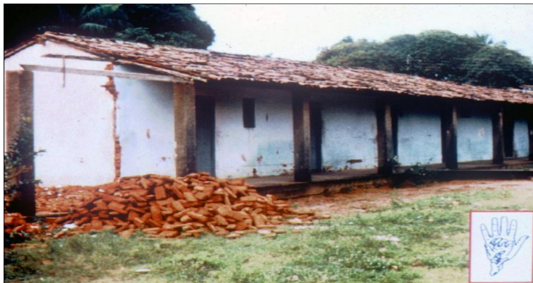
Figura 16 – Ruínas das casas da Rua da Frente
