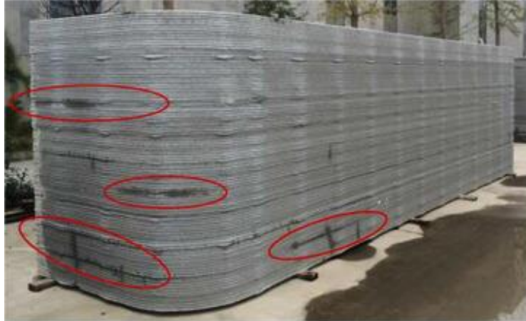
Figura 3 - Sinais de pronunciada infiltração local de água (destacada) nas interfaces da camada
