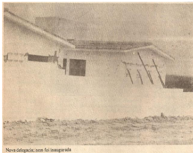
Imagem 19 – Escoras de madeira sustentando as paredes externas da delegacia.
