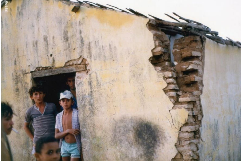
Imagem 14 - Casa da zona rural danificada pelos terremotos de 1986.
