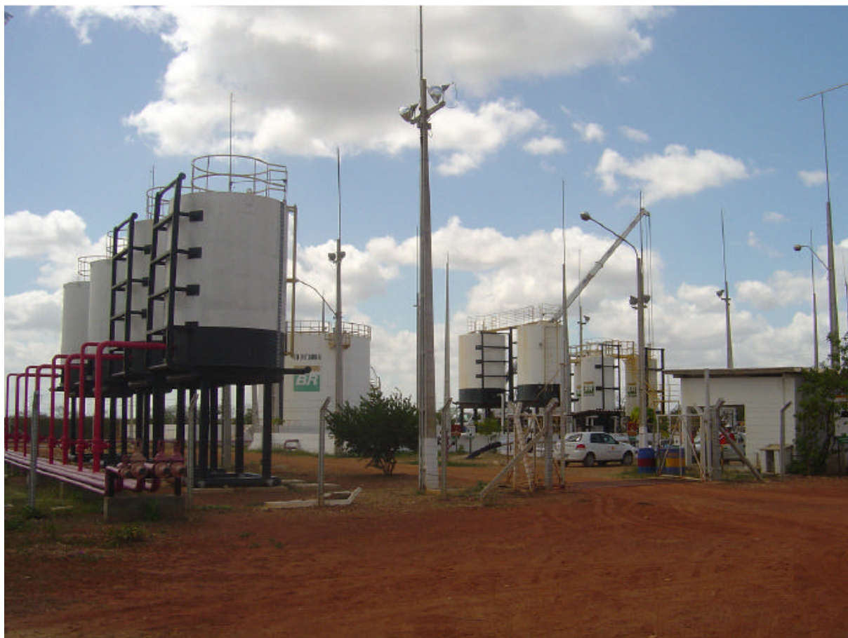
Figura 14 – Estação Coletora do campo de Monte Alegre – A
