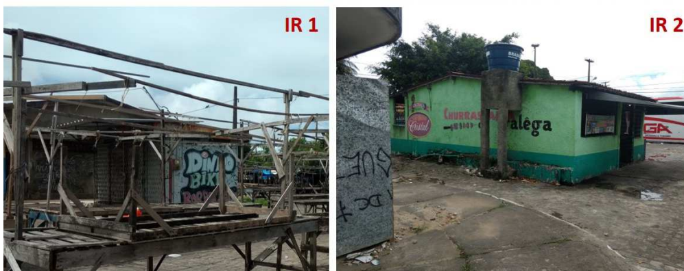
Fotografia 11- Edificações irregulares no mercado de Jaguaribe.
