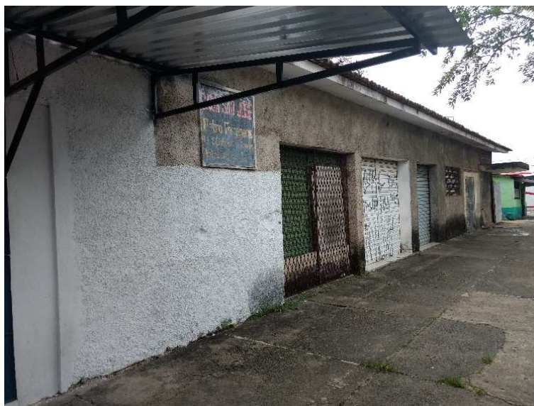
Fotografia 12- Desconfigurações das fachadas do bloco ímpar do mercado de Jaguaribe.
