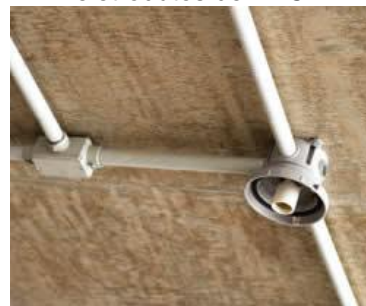
Figura 193: Instalação elétrica aparente com eletrodutos de PVC.
