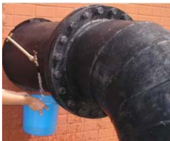
Figura 4 – Ponto 3: Depois da estação de tratamento da água
