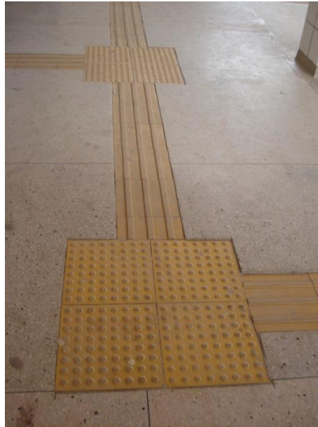
Figura 10 – Piso tátil na área de convivência da Escola
