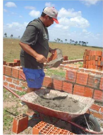
Figura 56: Mutirante trabalhando na etapa de alvenaria das moradias do assentamento Resistência Potiguar
