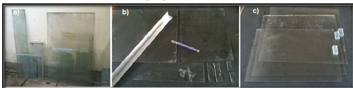
Figura 34 – Cobertura do forno: a) vidros reutilizados, b) corte das tampas e alças, c) tampas prontas com alças.
